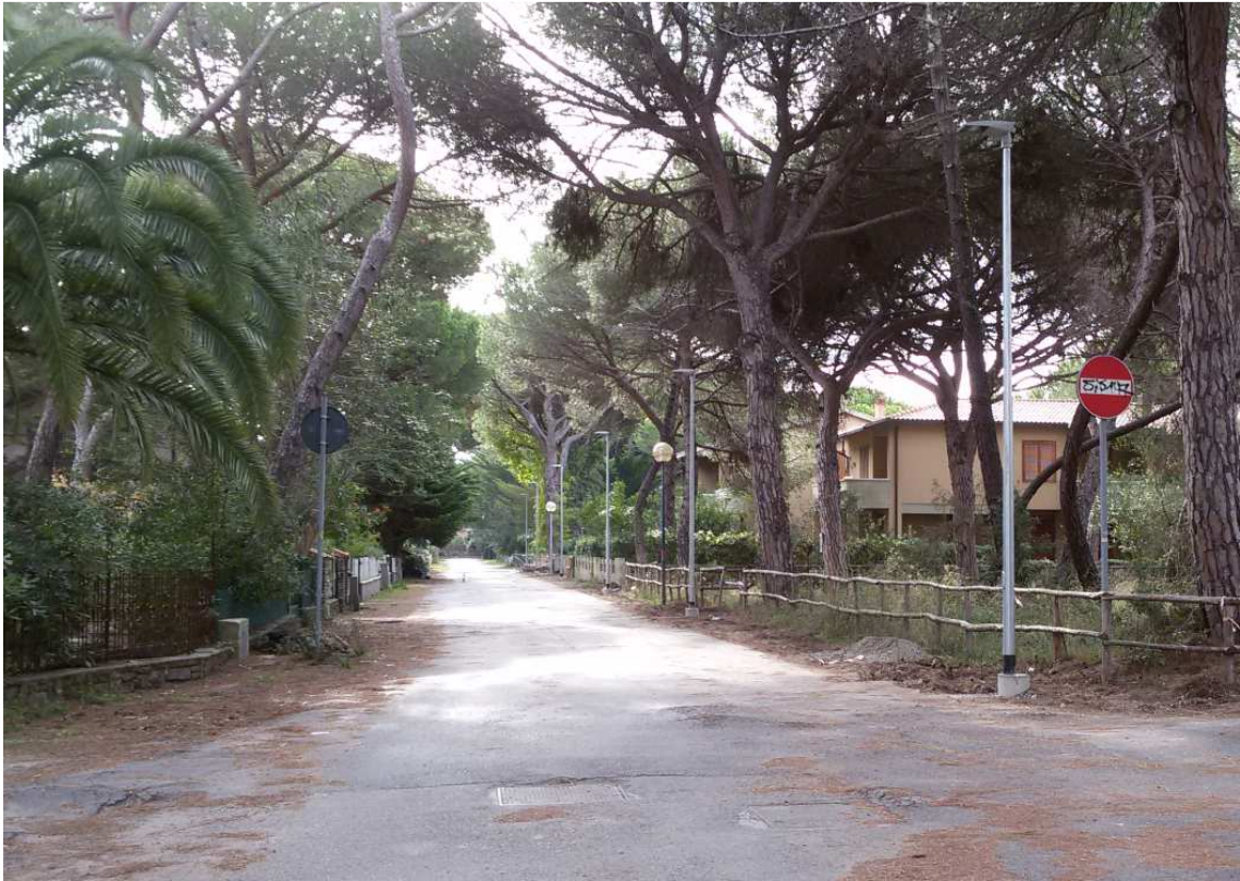
Foto 3 - armature stradale già a led facenti parte del primo stralcio 2015
