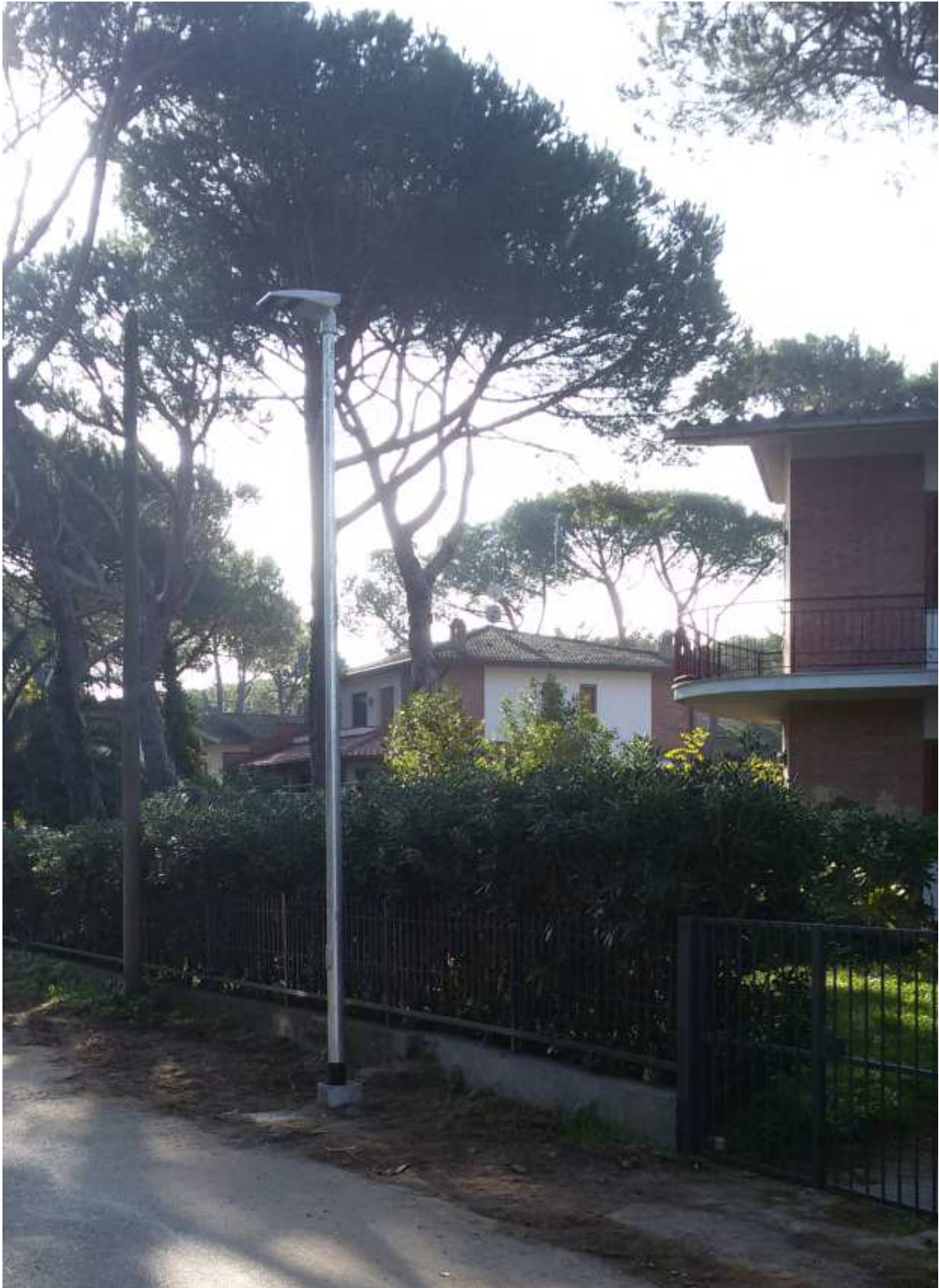
Foto 4 - armature stradale già a led facenti parte del primo stralcio 2015
